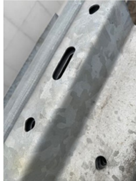
Powłoka po 4 latach
