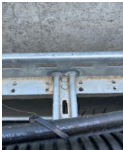
1. Nalot białej korozji
