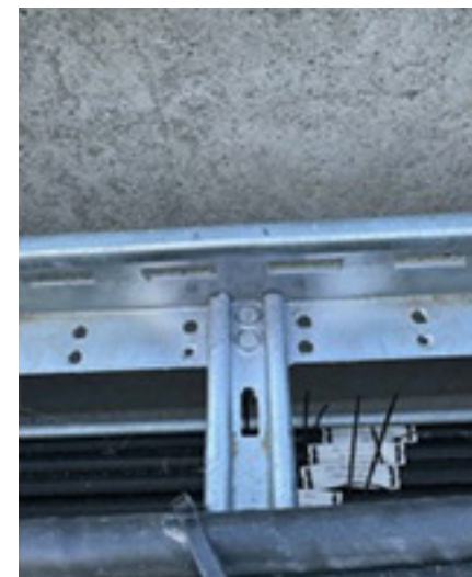
4. Po naniesieniu pasty cynkowej dopuszcza się zastosowanie cynku w sprayu ze względów estetycznych jednak w dłuższym terminie gdy powłoki cynkowe naturalnie ciemnieją cynk w sprayu nie zmienia barwy
